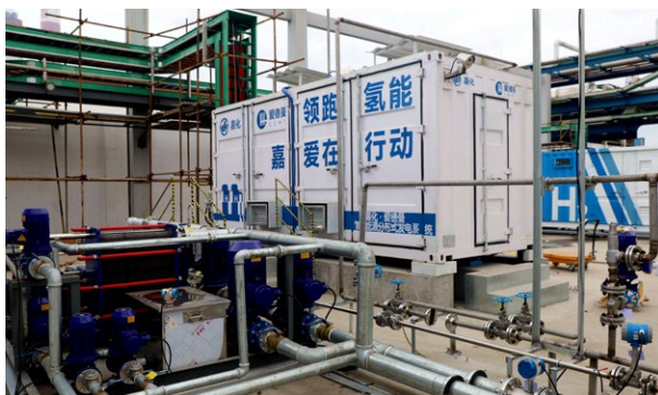
氢能发电项目
